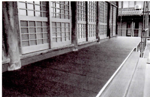
本堂向拝濡れ縁は、板が真新しく仕替えられ、見違えるよう。もう、ソゲが刺さることもなくなりました。隙間だらけだった本堂格子戸も、全面格子が入ったガラス戸に仕替えられ、本堂内も明るくなりました。
